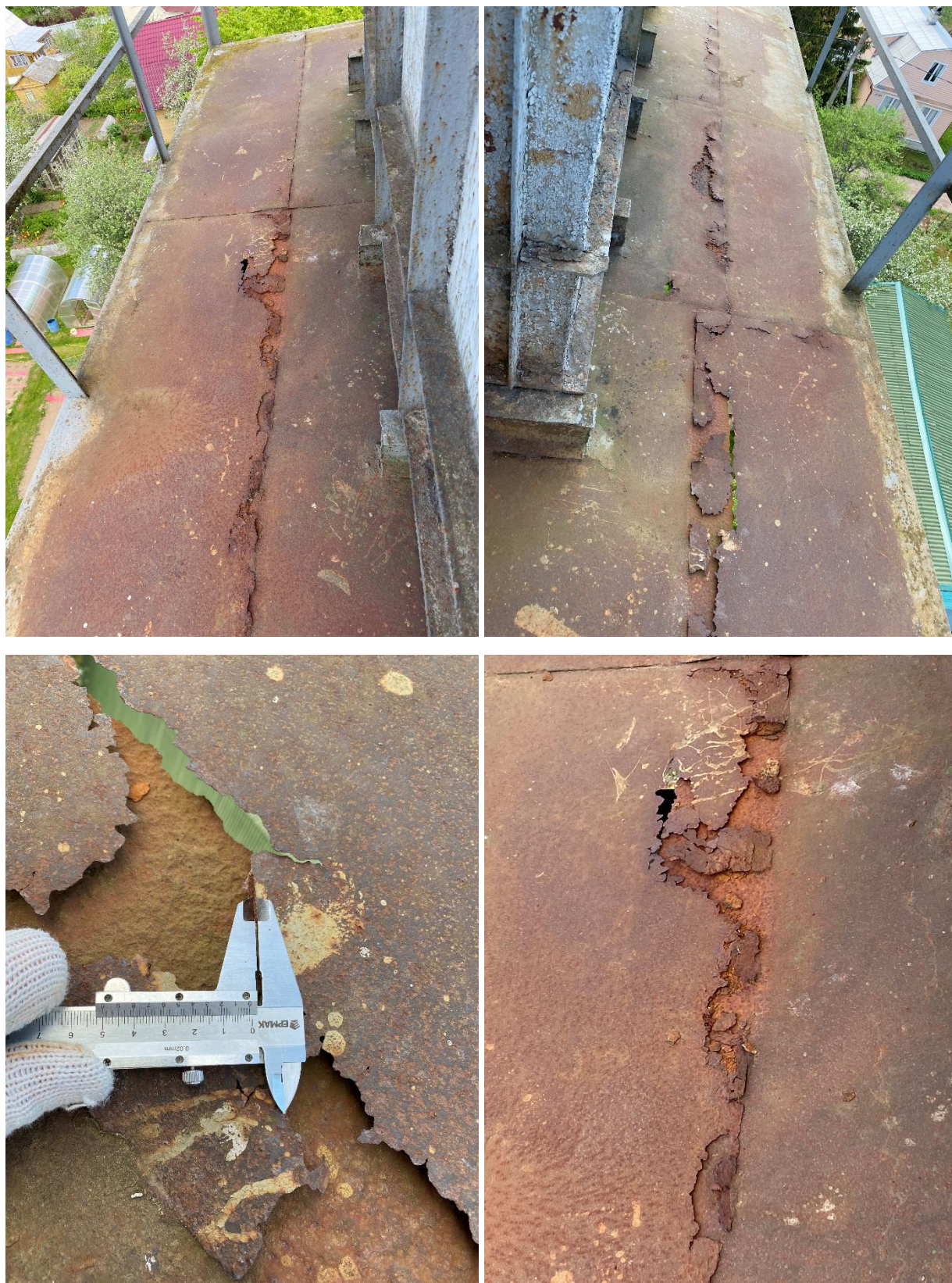
Фото №15-18. Ходовые мостки. Сквозная коррозия.
